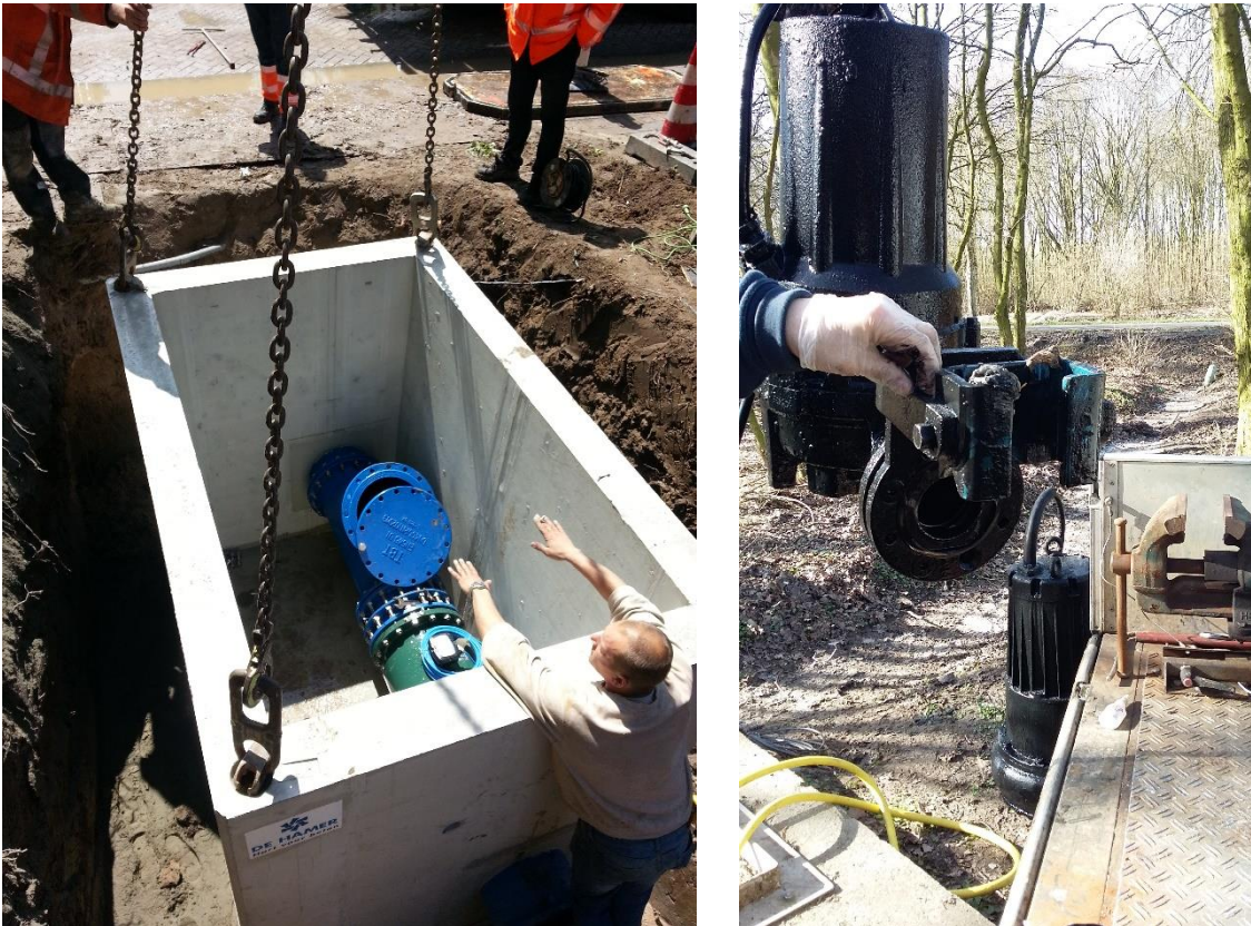
Figuur 5 - Renovatie (links) en jaarlijks onderhoud (rechts) van een gemaal. Bij renovatie worden optimalisatiekansen benut, bijvoorbeeld het terugbrengen van het aantal pompen of het herzien van de elektrische installatie ten behoeve van een lager energieverbruik.
