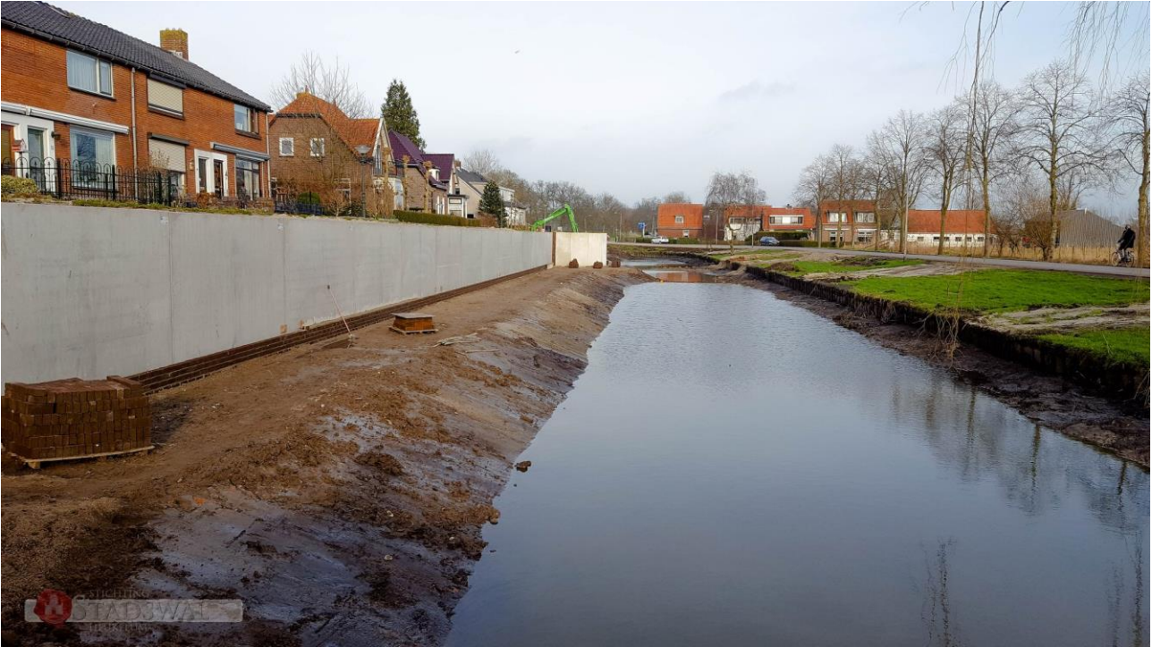
Figuur 4 - Realisatie waterberging Heukelum (2015-2018), in combinatie met burgerparticipatieproject voor herbouw van de stadswal.
