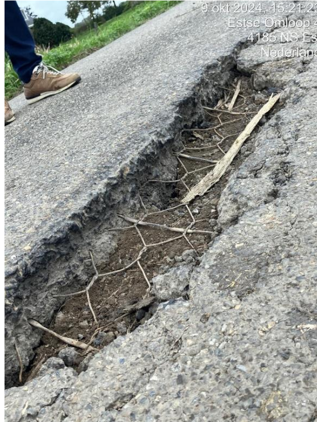
Slappe ondergrond en slechte fundering leidt regelmatig tot verrassingen in de praktijk.
