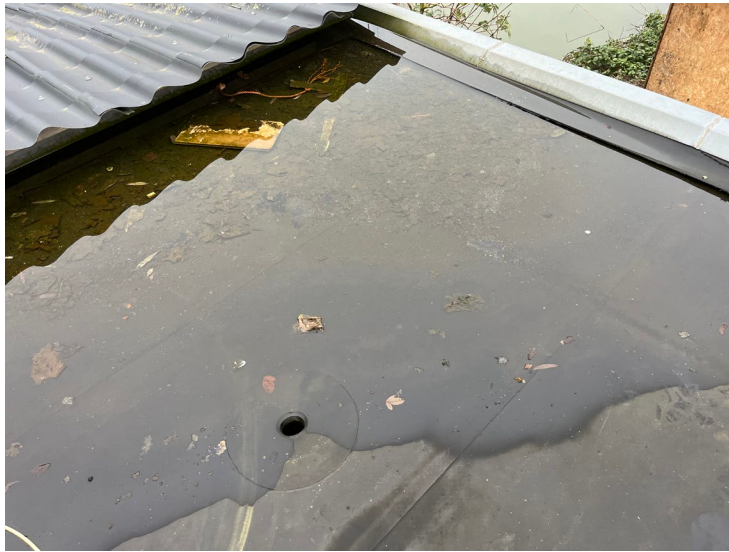
Lekkend dak berging
