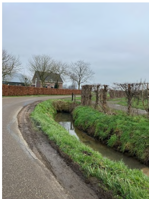
Figuur 10: Een weg met smalle schouders en beschadigde bermen
