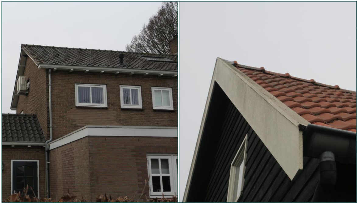
Figuur 3.2 Links: bij de bedrijfswoning (3) bevinden zich in de uitbouw met het platte dak bovenin open stootvoegen die vleermuizen als invliegopening kunnen gebruiken. Rechts: de boeiboorden van de schuur(4) sluiten strak aan op de muren en ook de potdekselplanken zijn strak afgewerkt.
